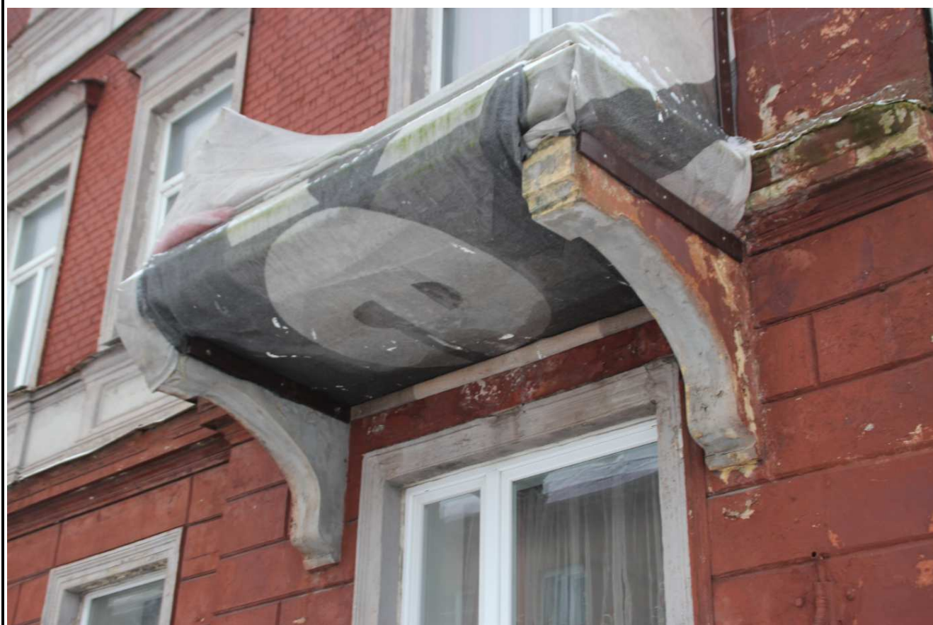
Att. 5. Ēkas Dienvidu daļas balkons (ar bojātām margām)
