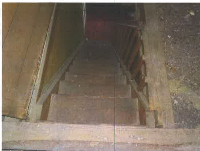
Kāpņu laukuma nesošā sija ieliekusies- nav atbalsts uz kāpņu telpas nesošo sienu.
